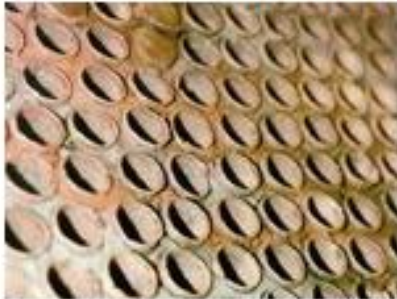
Schritt 1: Korrodierter Rohrboden
